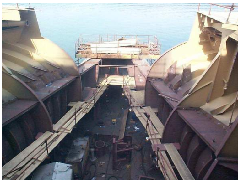
Slika : Prikaz strojarnice na novogradnji (Izvor: Brodosplit – Brodogradilište d.o.o. Split)
