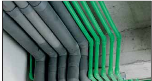
Uzlazni i razdjelni vodovi za grijanje se također planiraju i izvode s Fusiotherm ®-kompozitnim cijevima.
