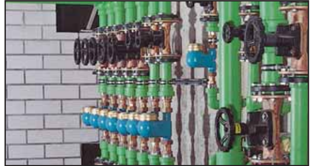
Spojevi s priрубnicama i prijelazni vijčani spojevi omogućavaju priključak svih elemenata u centrali za snabdjevanje i dalje na katu.
